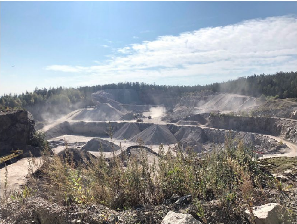
Bondkall pukkverk bygger i 2025 et fullskala vaskeverk for gjenvinning av masser. Foto: Ingelöv Eriksson
